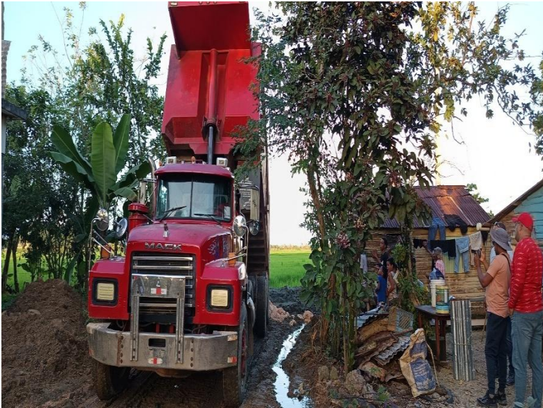
20. construcción de la carretera del pley a salir donde el profesor Ronny
